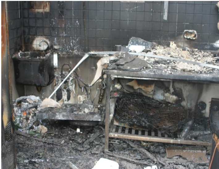
© weag-mv.de Brandschaden durch defektes Elektrogerät
